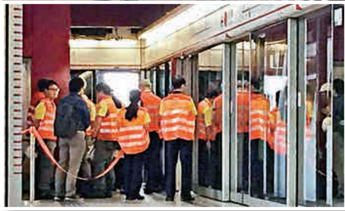
▲港鐵職員立即用支架固定發現裂痕路軌
