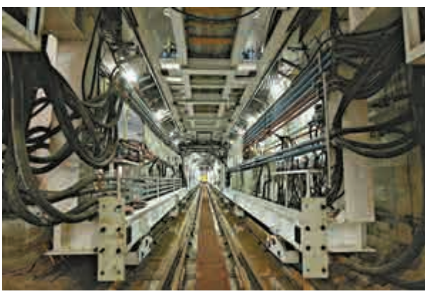
▲橫琴輕軌預計2018年年中全線建成通車。圖爲地鐵施工現場 大公報記者方俊明攝
