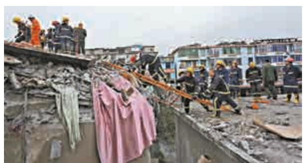
▲26日，消防隊員登上坍塌樓房的頂部進行搶險救援 新華社
