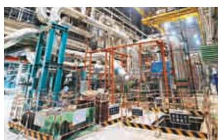
▲遼寧紅沿河核電站常規島內部發電附屬設施 新華社
