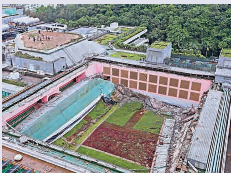
▲屋宇署公布城大塌屋頂調查初步報告，揭露原有屋頂結構或存在設計缺陷、工程質量欠佳等問題
