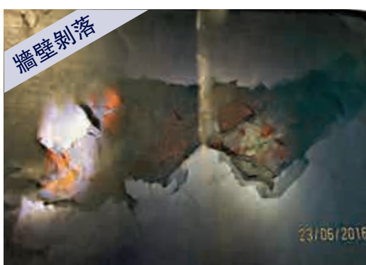
▲有部分的牆壁露出內裏的紅磚
