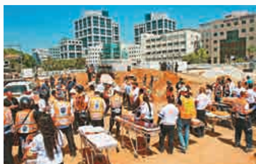
▲特拉維夫一個在建地下停車場建築工地5日發生坍塌事故 法新社
