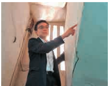
▲市建局高級經理（樓宇復修）李偉峰指，鶴園街2至4號唐樓確認存在石屎結構問題，故獲市建局資助維修 大公報記者曾敏捷攝
