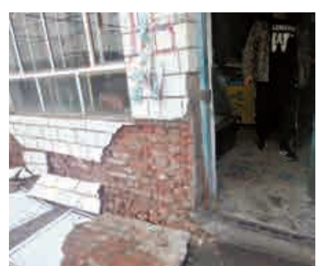
▲地震發生後，呼圖壁縣雀兒溝鎮一處農家院出現牆體裂縫、牆皮脫落 中新網
