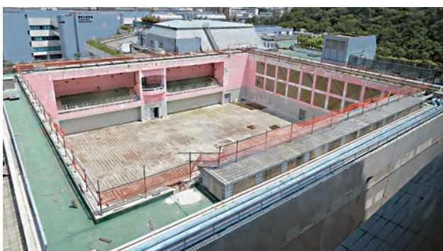
城大胡法光運動中心天台目前僅以鐵欄及橙色繩網圍封，惟未見有工程進行。大公報記者趙凱堯攝
