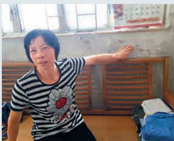
▲租客劉女士稱，客廳及睡房一直嚴重漏水
