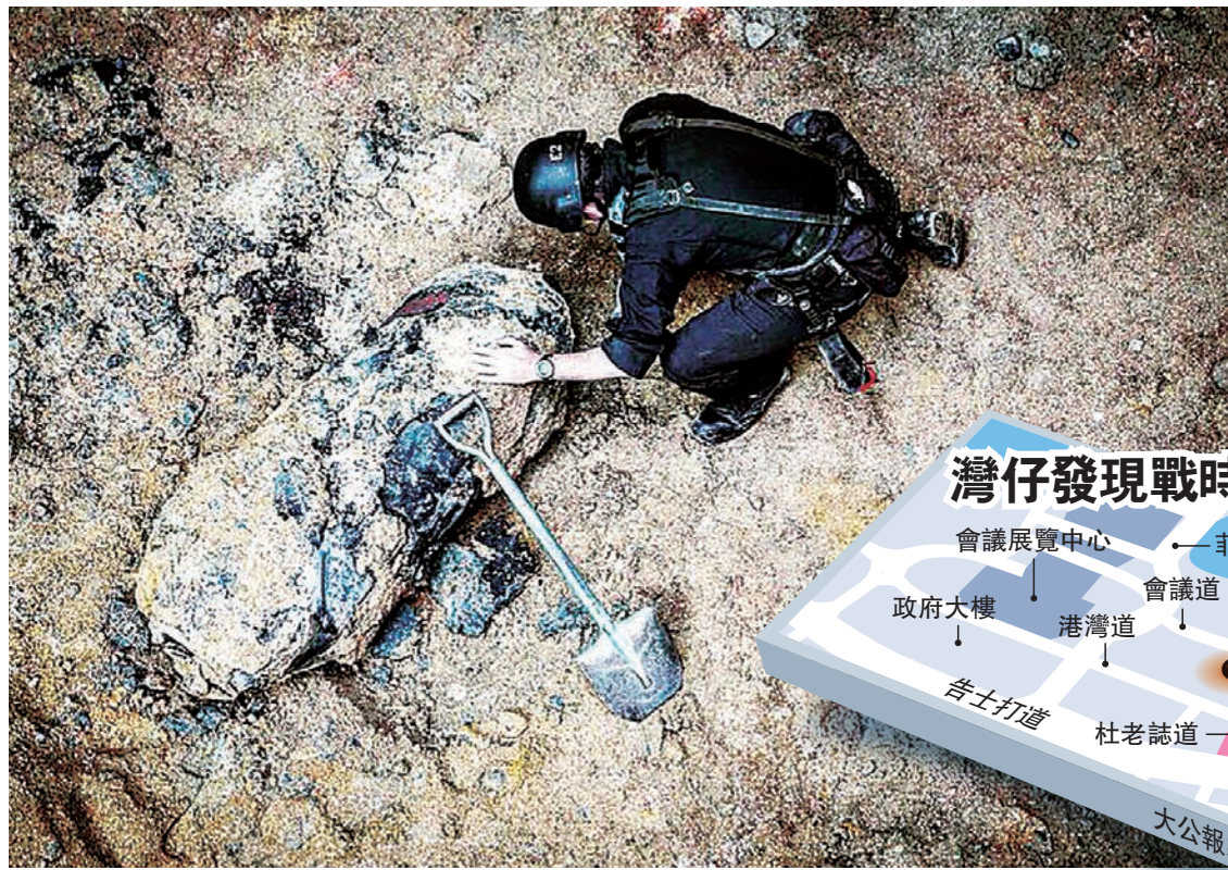
▲港鐵沙中線灣仔會展站地盤，昨晨掘出戰時美軍巨型炸彈，警方爆炸品處理課人員小心翼翼靠近檢查炸彈
