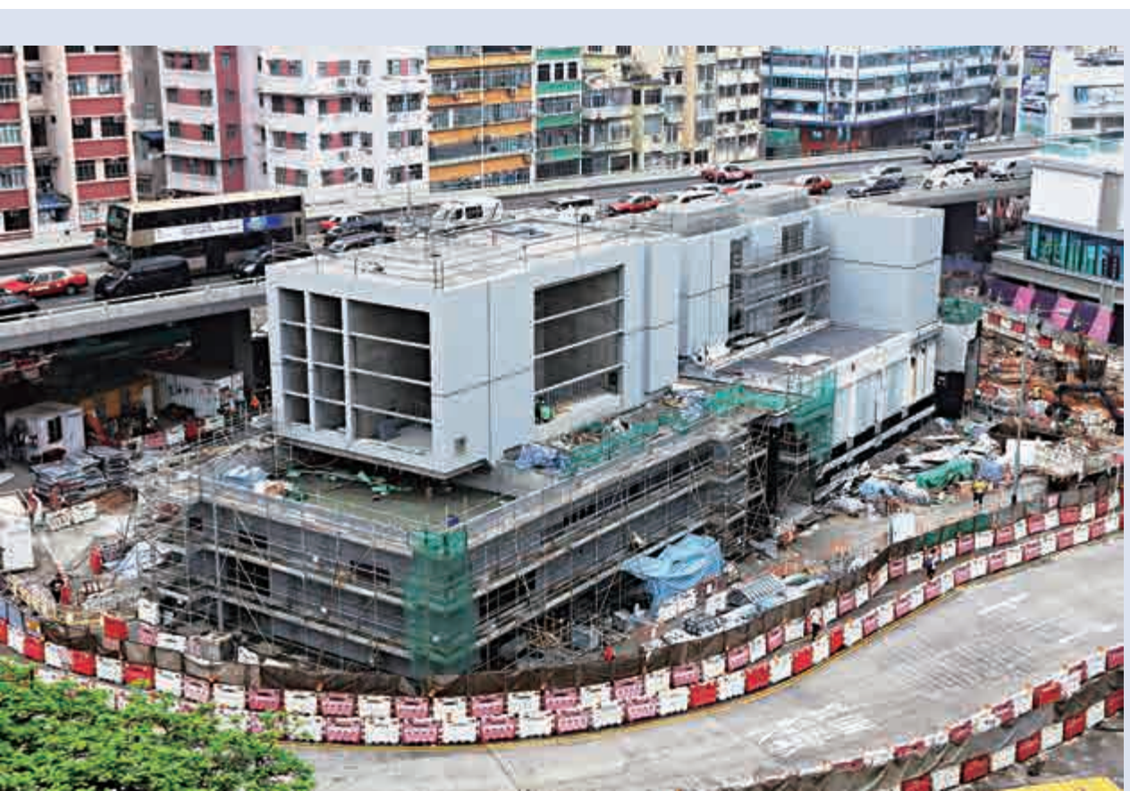
▲路政署承認上週二已得悉沙中線土瓜灣站結構牆「削筋」事件，要求港鐵一星期內交報告，詳細說明事故原因及修復方案 大公報記者林少權攝
