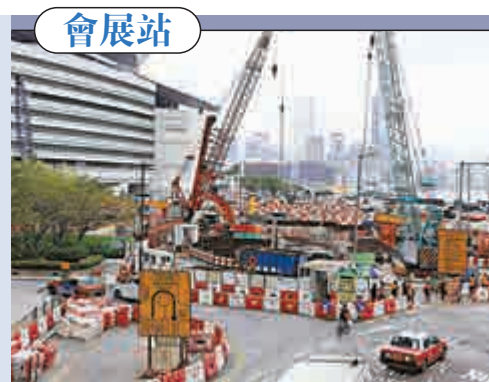
會展站 ●情況：挖掘工程沒有安裝足夠支撐
