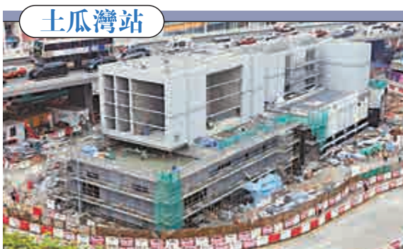
土瓜灣站 ●情況：三處共約60平方米混凝土牆身遭移除鋼筋，修復工程料7月展開、10月完成
