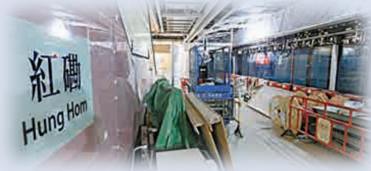
▲港鐵沙中線紅磡站工程問題引發刑事調查
