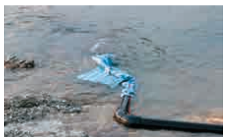
疑滲漏污水管部分被帆布包裹，見到有黑色臭水漏出 大公報記者張琦攝
