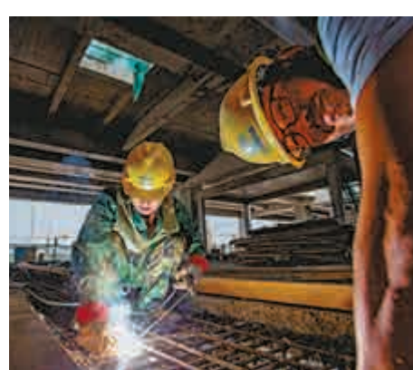
▲深圳光明中心站主體車站及區間周邊環境施工現狀 大公報記者黃仰鵬攝
