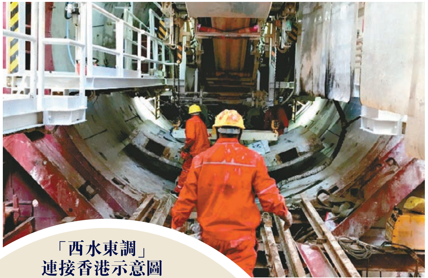
▲珠江三角洲水資源配置工程6日全面開工，將有效改變目前東莞、深圳、香港從東江取水的單一供水格局。圖為此前的工程試驗段建設現場。資料圖片
