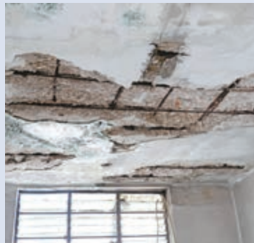
◀大廈公共空間多處日久失修，甚至鋼筋外露
