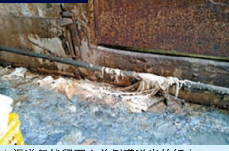
▲渠道仍然留下之前倒灌溢出的紙巾
