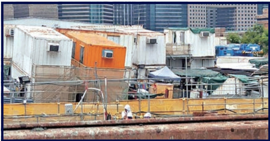
辦公貨櫃傾斜 ▲位於地盤邊沿的雙層貨櫃辦公室，因地陷而向同一方向傾側 網上圖片
