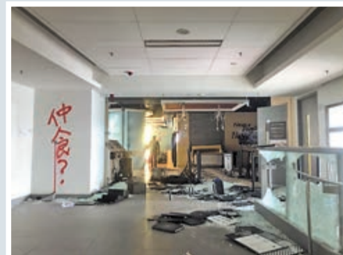
▲城大食堂遭破壞，現場一地狼藉
