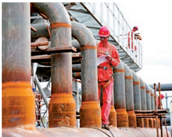
工人在中俄東線天然氣管道工程黑河首站施工現場施工。資料圖片
