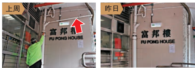
▲經《大公報》報道後，大窩口邨富邦樓地下的糞渠喉已被房署拆除
