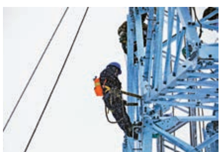
▲在西藏日喀則市定日縣，西藏阿里與藏中電網聯網工程線路4標段施工人員在暴風雪中作業 新華社
