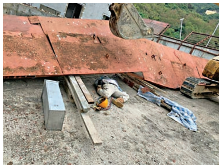
▲黃麻角徑香港青年協會建築地盤圍板倒塌，工人被壓上半身當場吐血 讀者提供圖片
