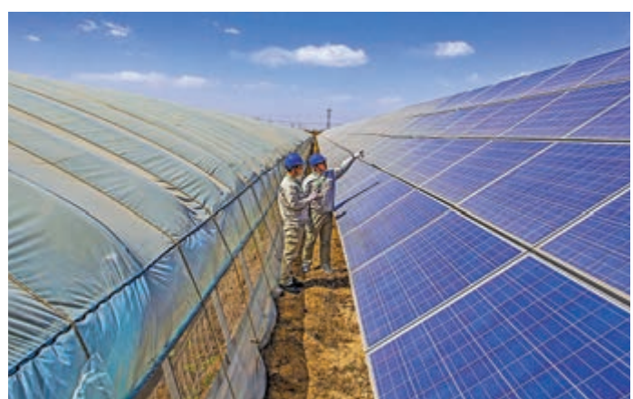
▲工作人員在河北武邑縣趙橋鎮光伏發電場維護光伏發電板。資料圖片
