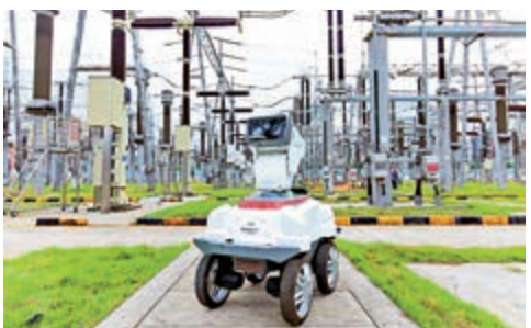
▲深圳鵬城變電站的5G巡檢機器人極大提高了工作效率。 網絡圖片
