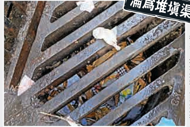
街渠內垃圾堆積至貼近地面。
