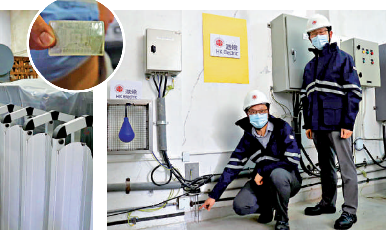
▲港燈為港島北電力設備加裝防洪設備，只要雨水觸碰到探測器便會通報總站，緊急斷電。
