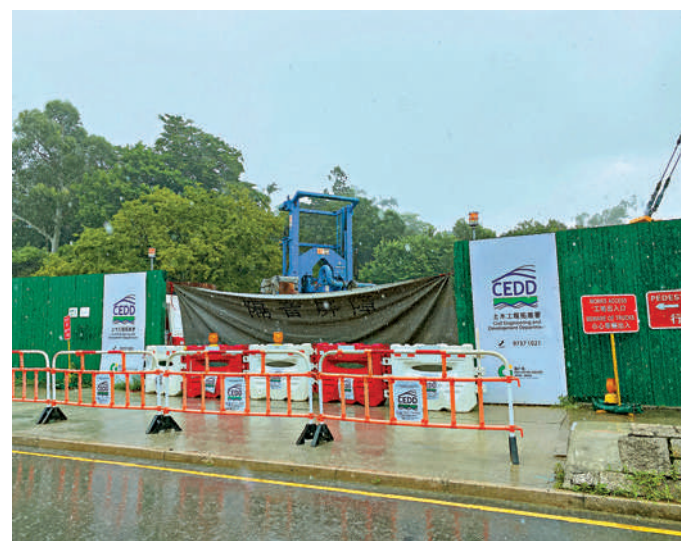
▲已規劃的道路工程中只有粉嶺繞道東段正在施工，情況不理想。圖為龍躍頭交匯處附近正建造橋墩。
