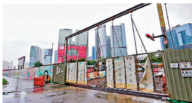
▲啟德發展區的新急症醫院工程在「獅子山」襲港期間出現沉降超標，地盤已停工進行加固措施。
