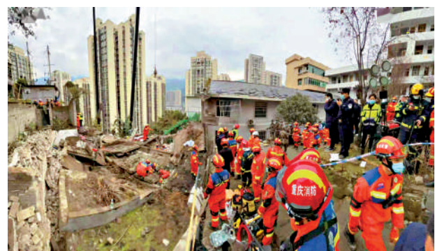
▲重慶市武隆區坍塌食堂的救援現場。網絡圖片
