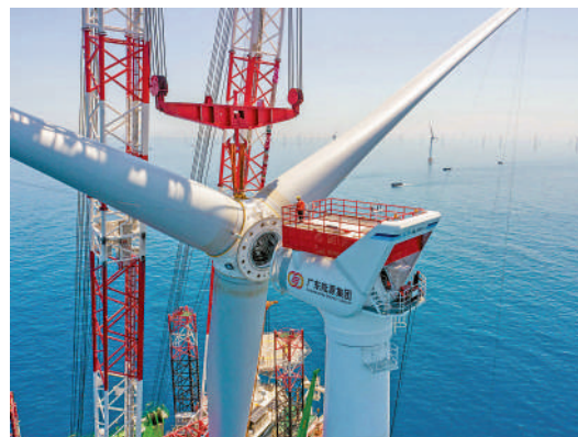
▲為達到減排目標，企業需要龐大資金，建設更多風力或太陽能發電設施。
