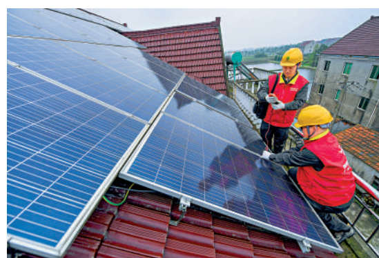
▲3月31日，在浙江湖州市齊星村，工作人員為當地村民的太陽能屋頂光伏電站巡檢。
