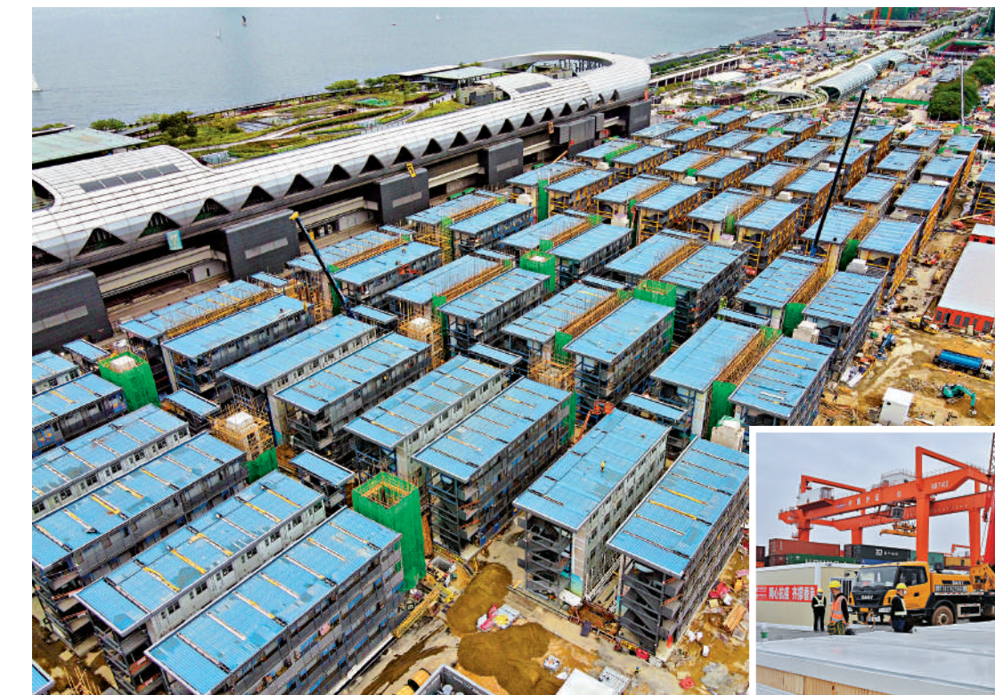
◀4月30日，中央援港的啟德社區隔離治療設施正在施工中，大量方艙拔地而起。 中通社
