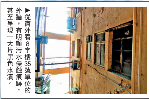
從窗外看8字樓35號單位的外牆，有明顯污水侵蝕痕跡，甚至呈現一大片黑色水漬。
