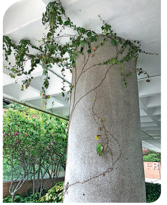
▲蔓延到混凝土柱頂和天花的藤蔓植物。
