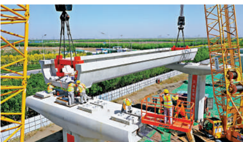
▲圖為泰達控股作為牽頭方之一建設的天津市軌道交通Z4線一期工程基建項目。
