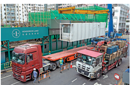
▲預算案提出將加強「組裝合成」供應鏈。圖為香港首個以「組裝合成」建築技術興建的過渡性房屋項目「南昌220」。 中新社
