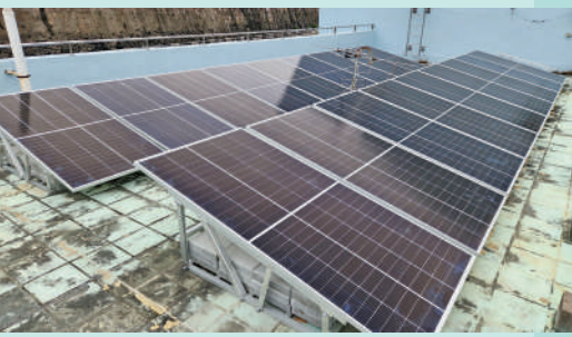
學校於「生態保育360」室旁安裝太陽能板，運用能源監察系統進行教學活動，讓同學更了解再生能源的供電原理。
