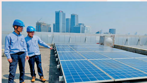
▲南方電網深圳前海供電公司投資建設了屋頂光伏。
