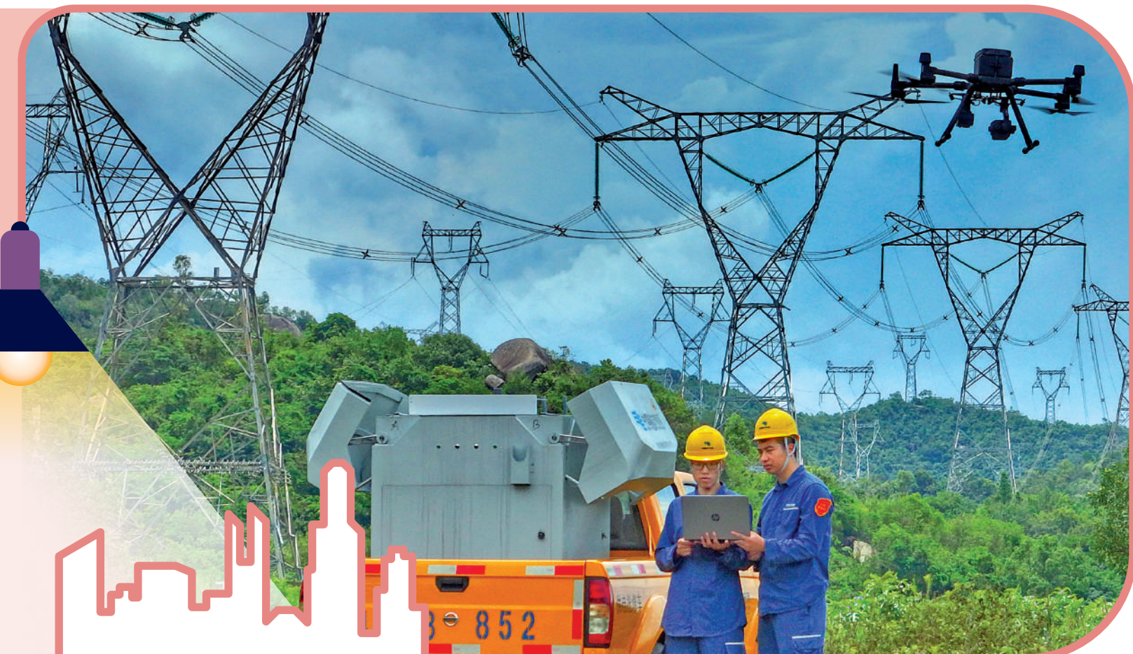
▲南方電網深圳供電局輸電線路運維人員利用車載移動機巢搭載無人機群對400千伏核深線進行特巡特維。
