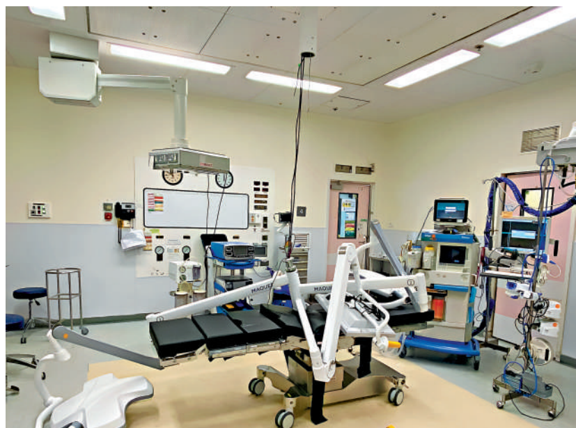
聯合醫院上週六有大型手術燈從天花板掉落，手術燈部分電線被扯斷。
