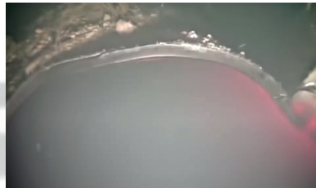
損▶「北溪」管道在爆炸中嚴重受損。視頻截圖
