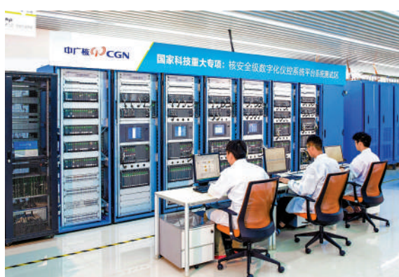
▲國家能源核電站數字化儀控系統研發中心工作場景。受訪者供圖
