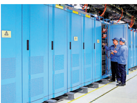
▲陽江5號機組核級DCS機櫃工廠測試。受訪者供圖
