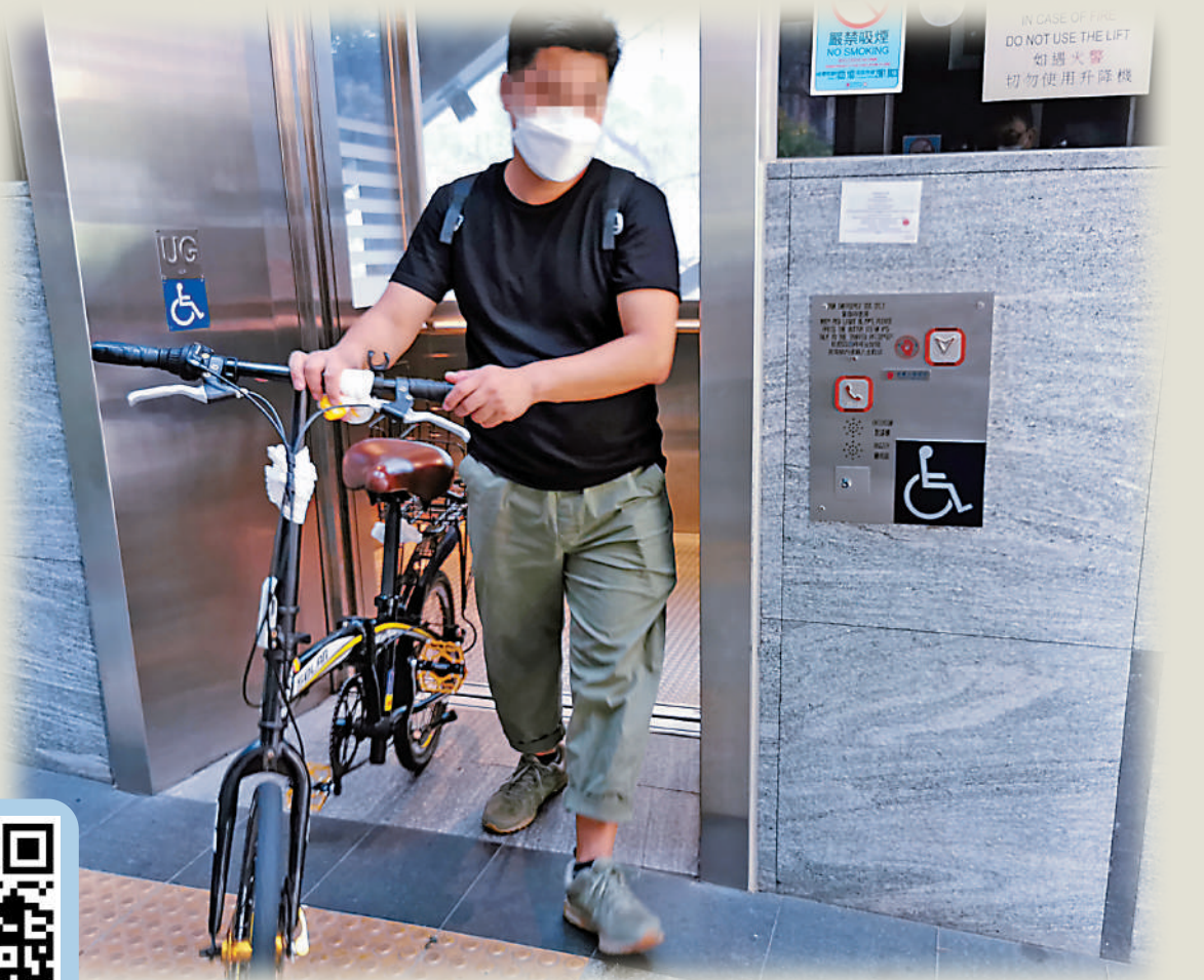
▲連接葵涌大窩口道至禾塘咀街的升降機系統，設有兩部無障礙斜道升降機，不過經常被人當貨載使用。記者採訪當日就見有居民用升降機運單車。
