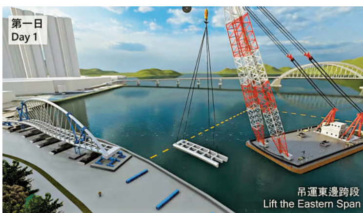
▲土木工程拓展署今日起開始吊運及安裝將軍澳南橋，把橋樑組件逐一移到海上原定位置。
