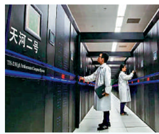
▲國家超級計算機廣州中心的技術人員在檢查「天河二號」超級計算機。
