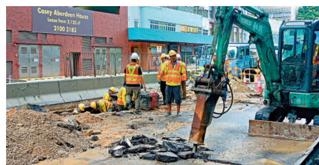
▲黃竹坑道近甄沾記大廈昨日爆水管導致地陷，工人在場搶修。
