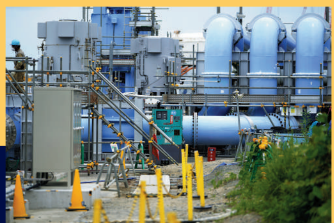
▲福島第一核電站排放核污水入海的部分管道。美聯社
